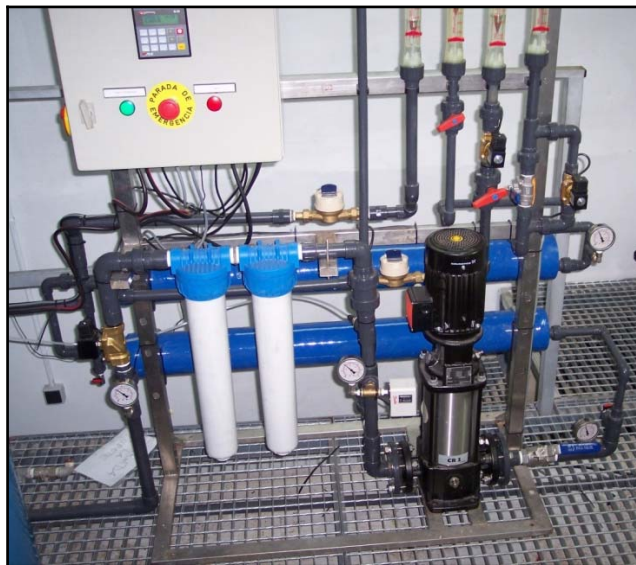
Figura 9. Filtración con membranas de osmosis Inversa en planta UJI.
