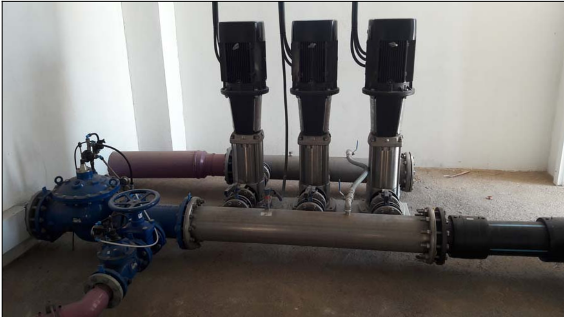
Figura 14. Grupo de bombeo para impulsión del agua regenerada.
