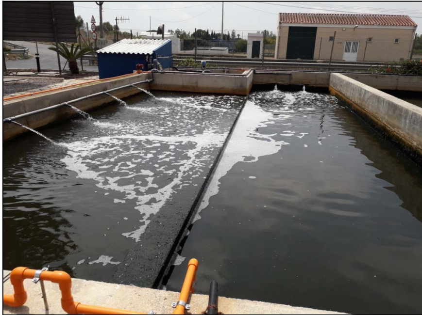
Figura 13. Canal de cloración.
